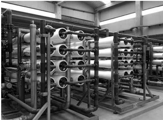
写真-3 バルセロナ処理場の逆浸透装置
