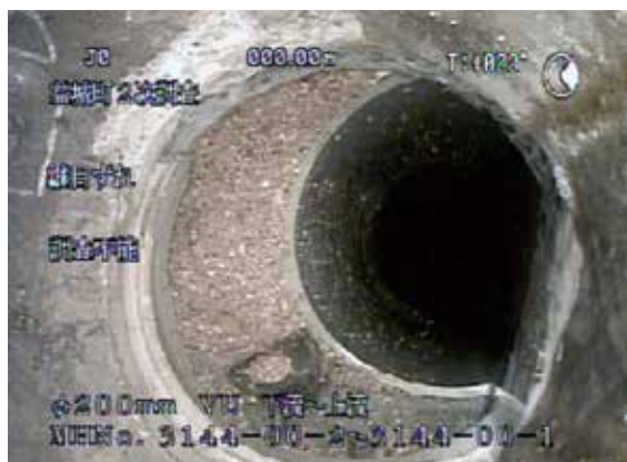
写真－2 硬質塩化ビニル管被災状況
