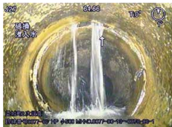
写真－4 破損による浸水（鉄筋コンクリート管）
