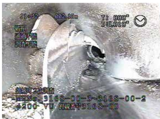
写真－1 硬質塩化ビニル管被災状況
