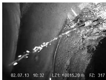
E: 取付管からのジェット状の漏れ
