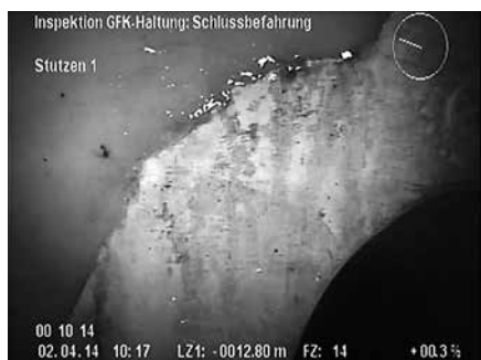
D: 滲みはあるが浸透はない
