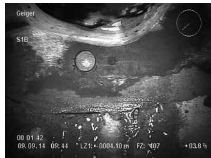
E：コンクリート管への接続取付管の水漏れ
