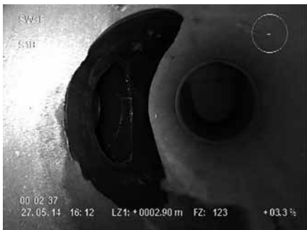
D：水漏れはないがしみのある例2
