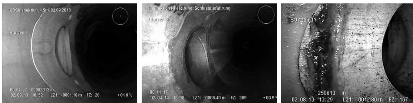
A: ガラス繊維強化型更生管への取付管の良好な接続
