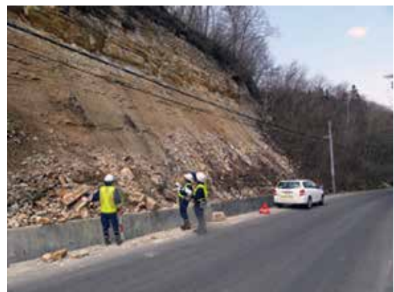
写真-2 自主調査による被害実態調査
