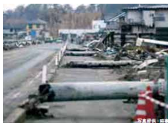
写真－1 津波による電柱折損
