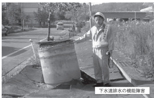
写真-1 マンホール浮上現象による被害①
