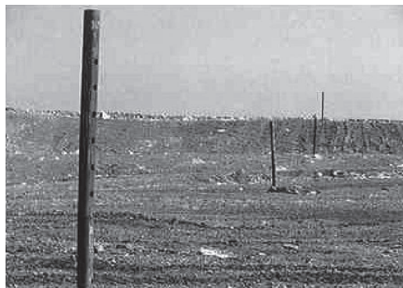
写真-2 ガス抜き用パイプ
