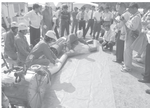
写真-6 曲がりの多い取付管も大丈夫
