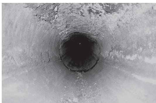
写真－3 既設老朽管の内部状況
