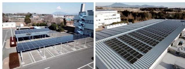
写真－2 太陽光発電（左：駐車場、右：多目的実験棟屋根）
