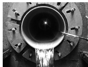
地下水排出状況
