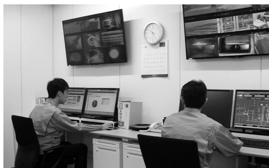
遠隔監視センターの様子
