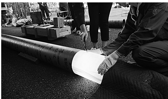
ハンマーで叩き、シームレスライナーの硬化状況を確認
