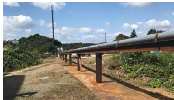
写真-1 実証設備
