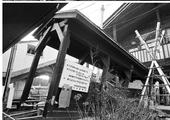
穴水駅周辺は激しく被災していました
